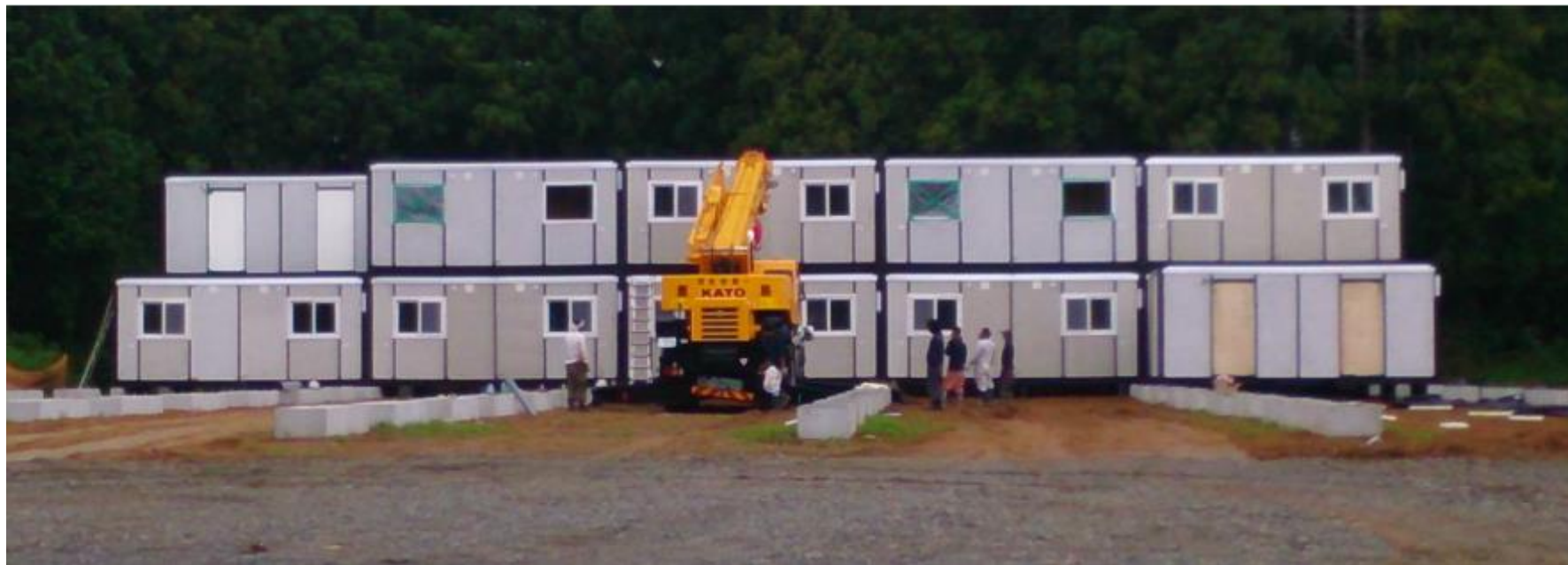
※写真は南相馬被災地の作業員用の400室宿舍例
